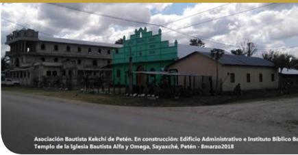
Asociación Bautista Kekchí de Petén. En construcción: Edificio Administrativo e Instituto Bíblico del Templo de la Iglesia Bautista Alfa y Omega, Sayaxché, Petén - 8 marzo 2018
